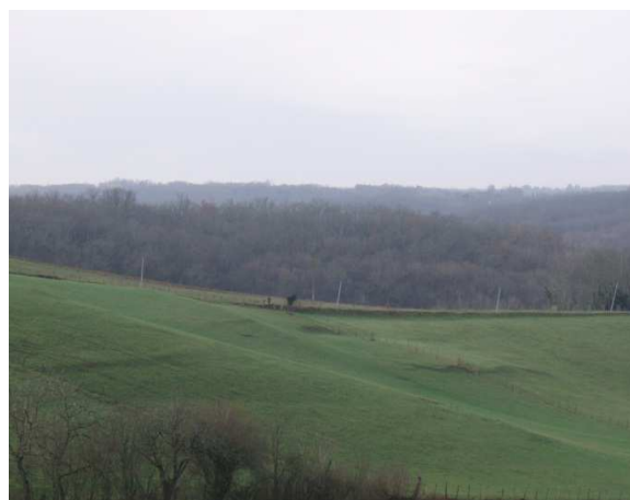
Figure 12 : Commune de Cazès Mondenard -Lieu dit « Pech Sadoul » Phénomènes de fluage et glissement supposé
