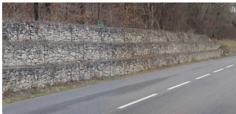
Figure 20 : Commune de Lauzerte Lieu dit « Serre Sèque » Ancien grand glissement stabilisé par des gabions
