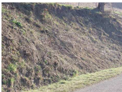
Figure 13 : Commune de Montagnudet Lieu dit « Laval» Loupe de glissement dans le talus
