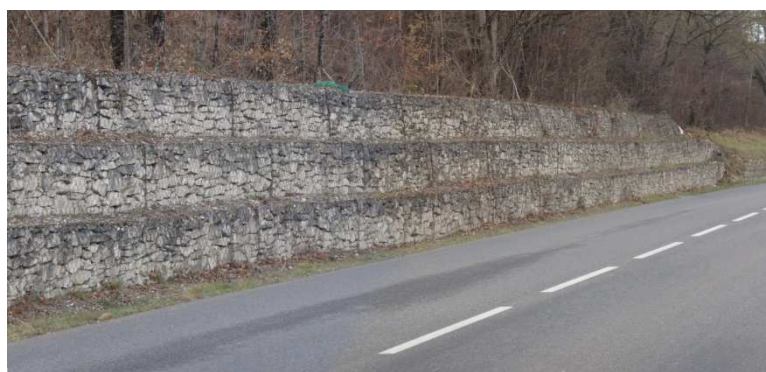
Figure 20 : Commune de Lauzerte Lieu dit « Serre Sèque » Ancien grand glissement stabilisé par des gabions
